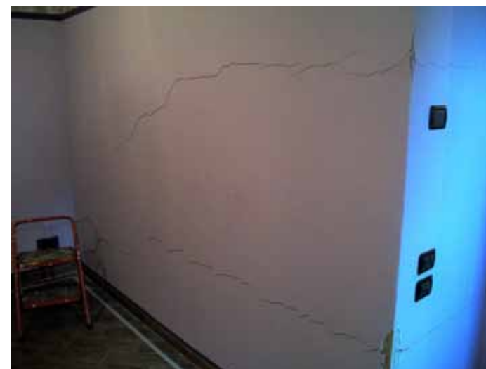
Stato fessurativo parete portante
