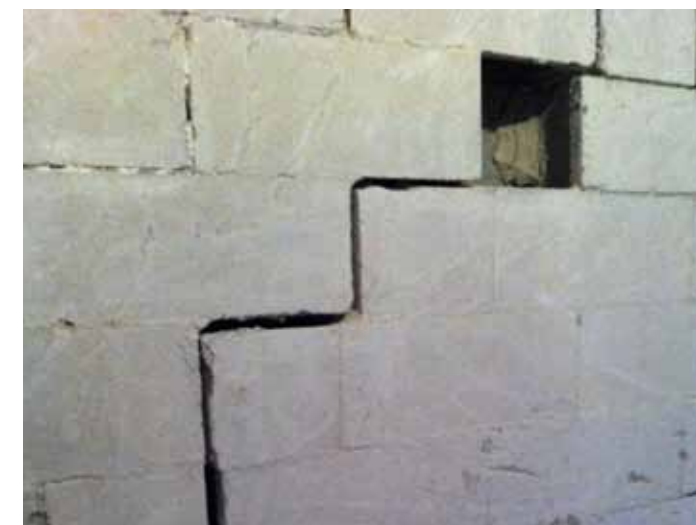
Muratura in blocchi di cemento e particolare dello stato fessurativo
