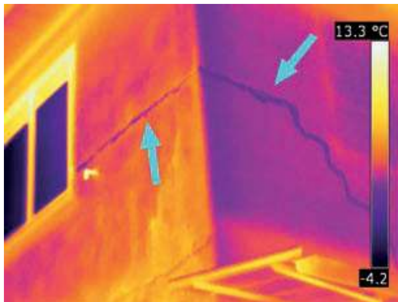
Interruzione dello strato superficiale di rivestimento.
